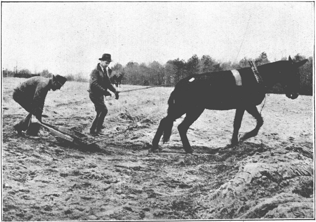
Fig. 6 — Pá de cavalo construindo um terraço de base larga. (Cortesia de Mr. Staton McIver, Salisbury, N. C., EE. UU.)
